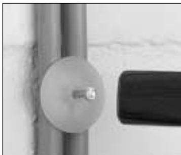
Eine Nagelscheibe für mehrere Kabel
