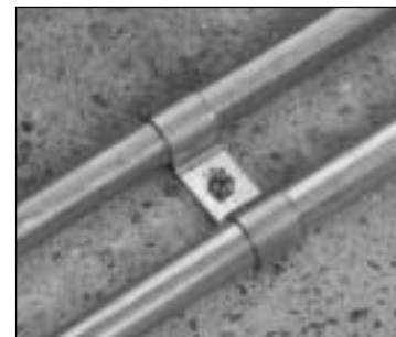
Vor-/Rücklauf für Heizung
