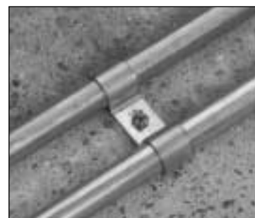
Vor-/Rücklauf für Heizung
